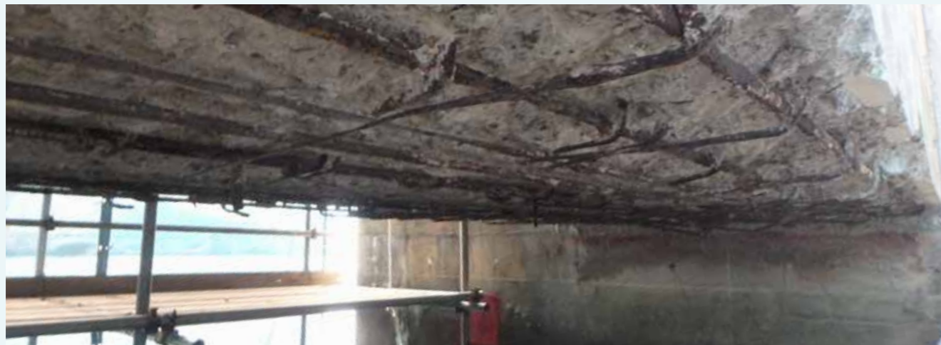
鉄筋腐食劣化状況
