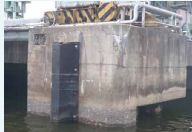
A S R・塩害 複合劣化状況
